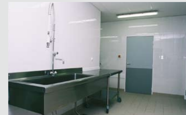
Cuisine collective - Centre de tri de la Poste Paris 14e
